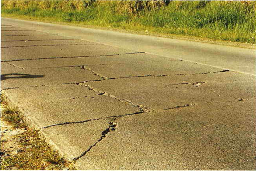
Photo 2.7.3. Chaussée en béton ; dalles rompues, joints dégradés et épauffrés
