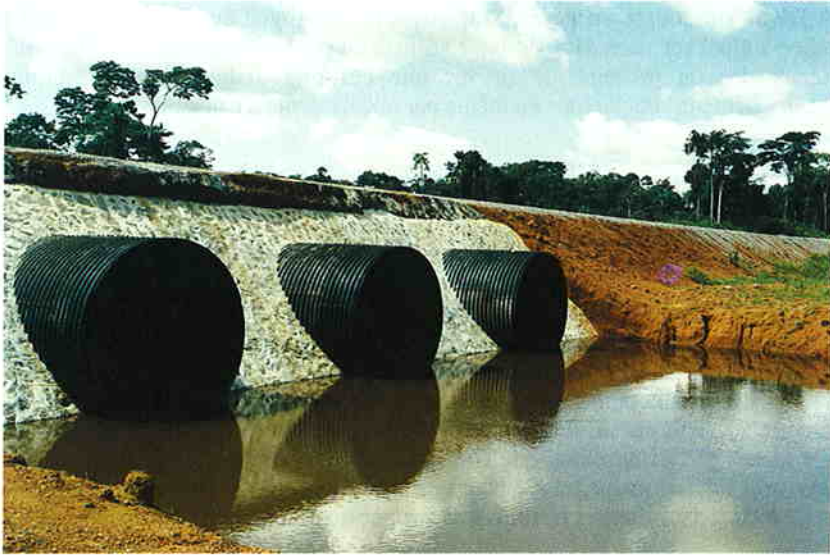
Photo 2.8.14. Buse métallique de grandes dimensions et perrés maçonnés (Cameroun)
