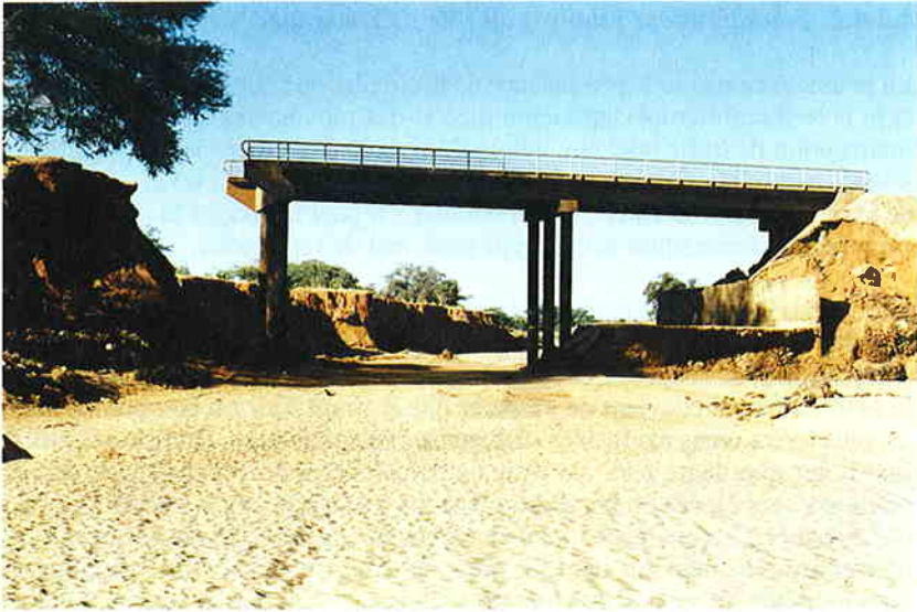
Photo 2.8.2. Débouché insuffisant Remblai d'accès emporté
