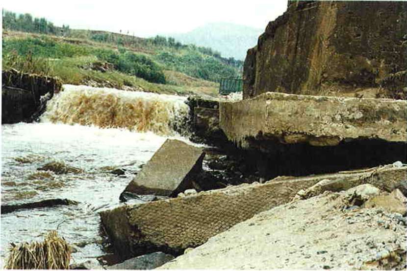
Photo 2.8.1. Affouillement de fondation (Burundi)
